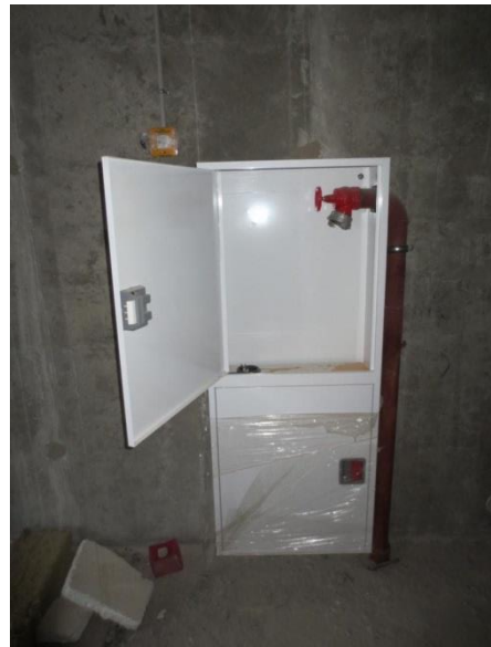
Фотография 44. Система пожаротушения
