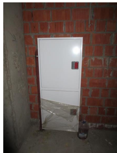
Фотография 46. Система пожаротушения
