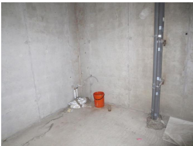
Фотография 25. Холодное, горячее водоснабжение
