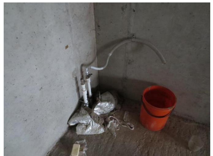
Фотография 26. Холодное, горячее водоснабжение
