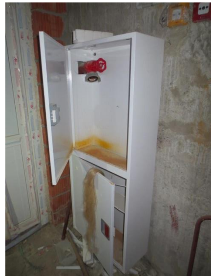
Фотография 24. Система пожаротушения
